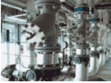
Циркуляционные насосы, обслуживающие холодильную станцию, с регулировкой посредством инвертера.
