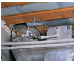
Обвязка теплообменного оборудования выполнена из полипропиленовых труб
