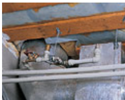
Обвязка теплообменного оборудования выполнена из полипропиленовых труб
