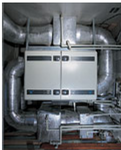
Сверх-компактное размещение в венткамере агрегата Gold (PM-Luft) и тепло-обменного оборудования с обвязкой (догревающий калорифер, охлаждающий теплообменник, конденсатор холодильной машины)
