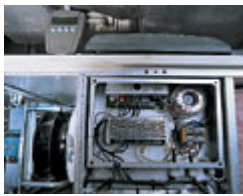
Управляющий контроллер встроен в корпус агрегата Gold. Для диалога с пользователем агрегат оборудован проводным русифицированным пультом управления
