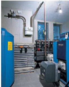
Сердце котельной - котел Logano G315
