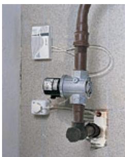
Газоанализатор позволяет своевременно перекрыть подачу газа к горелке котла при утечке
